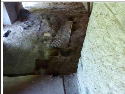
Photo n° 1384T2 Localisation : Plancher étage écurie Ouvrage : plancher étage en partie effondré
