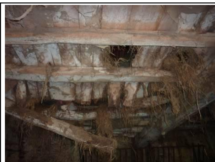
Photo n° 1384T1 Localisation : Ecurie: plancher étage Ouvrage : plancher étage écurie en partie effondré
