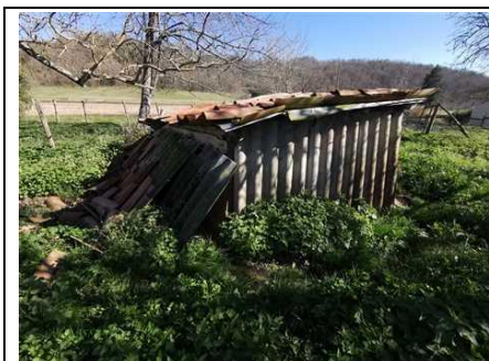
Photo n° PhA006 Localisation : Rez de jardin - abris chèvre et volière Ouvrage : 2 - Parois verticales extérieures - Façades légères, bardages, Partie d'ouvrage : Plaques Description : Plaques Localisation sur croquis : M006
