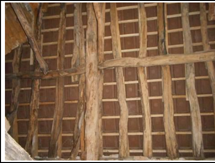
Photo n° PhTer001 Localisation : l'ensemble du bien Ouvrage : l'ensemble des bois anciens Informations complémentaires : bois piqué - Parasite(s) identifié(s) : Insectes à larves xylophages
