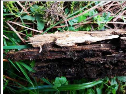
Photo n° PhTer002 Localisation : jardin - jardinière Parasite : Présence d'indices d'infestation de termites, Termites souterrains Indices : altérations dans le bois, termites souterrains vivants, bois d'apparence feuilleté, dégradation du bois
