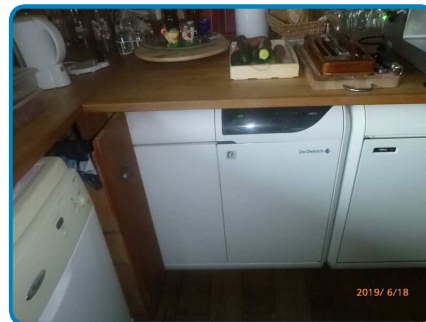
Appareil n°2 (Chaudière mixte) sur installation n°1 (dans Maison Rdc Salle à manger - Cuisine)
