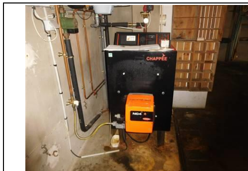
Photo n° Gaz004 Localisation : Rez de chaussée - Garage Chaudière CHAPPEE (Type : Raccordé)
