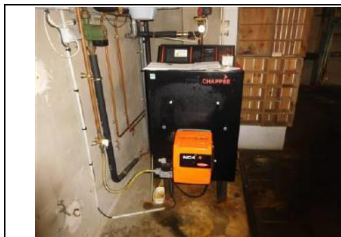
Photo n° Gaz004 Localisation : Rez de chaussée - Garage Chaudière CHAPPEE (Type : Raccordé)
