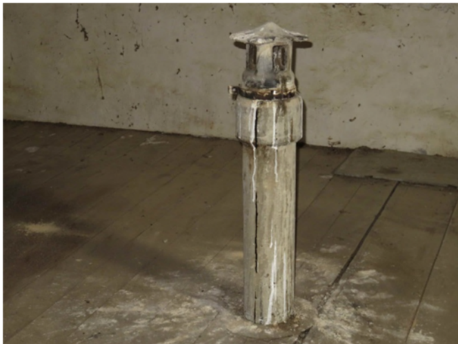
Conduit de ventilation en amiante ciment salle de bain débouchant dans les combles
