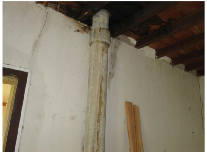
Conduit de ventilation en amiante ciment salle de bain Débouchant dans la pièce 1
