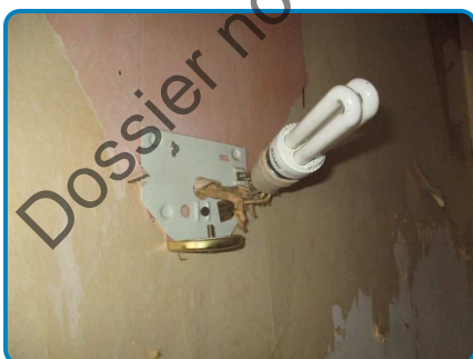
Anomalie B.7.3 a sur Install. n°1
