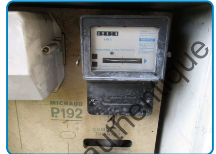
COMPTEUR sur Install. n°1 (dans Rez de chaussée Extérieur)
