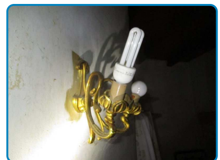
Anomalie B.8.3 a sur Install. n°1
