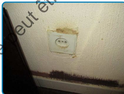
Anomalie B.3.3.6 a1 sur Install. n°1
