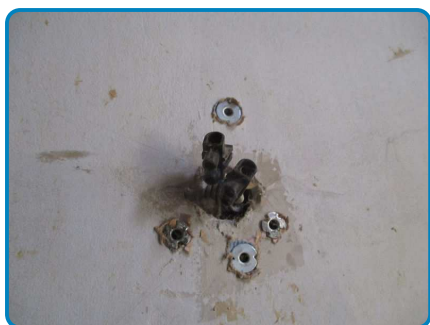
Anomalie B.8.3 e sur Install. n°1
