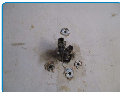
Anomalie B.7.3 d sur Install. n°1
