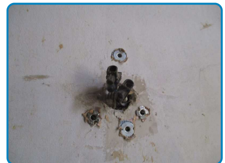
Anomalie B.3.3.6 a3 sur Install. n°1
