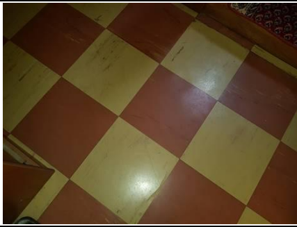
Photo n° 1408A1 Localisation : Palier R+1, palier R+2 Ouvrage : Idalle de sol 30x30 rouge et jaune M001 sans amiante (analyse jointe)
