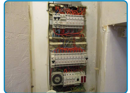
TRP n°1 sur Install. n°1 (dans Rez de chaussée Entrée)
