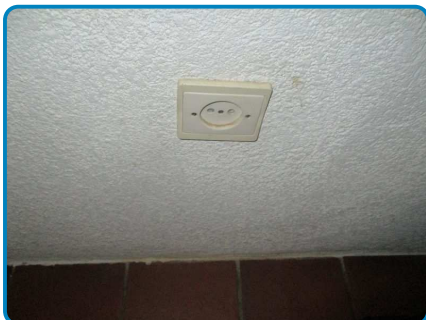
Anomalie B.3.3.6 a1 sur Install. n°1
