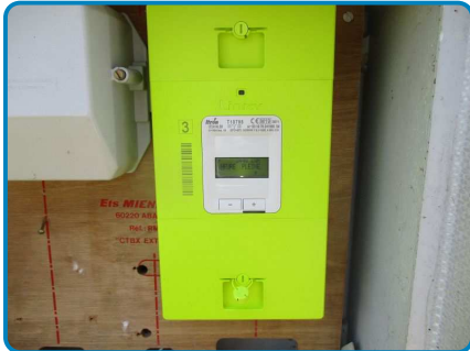
COMPTEUR sur Install. n°1 (dans Rez de chaussée Extérieur)
