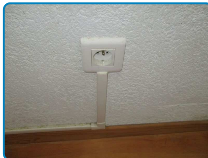
Anomalie B.3.3.6 a3 sur Install. n°1
