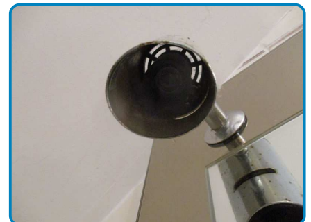
Anomalie B.7.3 c2 sur Install. n°1
