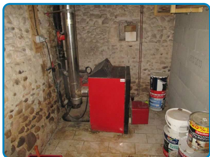
Rez de chaussée Chaufferie
