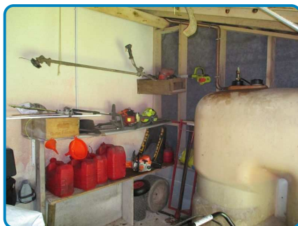
Rez de chaussée Local cuve
