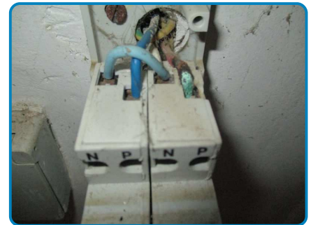
Anomalie B.4.3 h sur Install. n°1 App. n°1 (TRS n°1)
