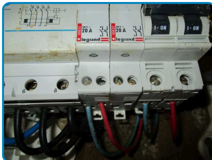
Anomalie B.4.3 e sur Install. n°1 App. n°2 (TRP n°2)
