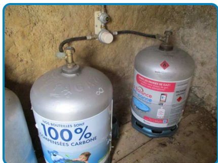
Installation n°1 (Propane) (dans Dépendance Rez de chaussée Porcherie n°2)
