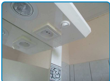
Anomalie B.5.3 a sur Install. n°1 App. n°2
