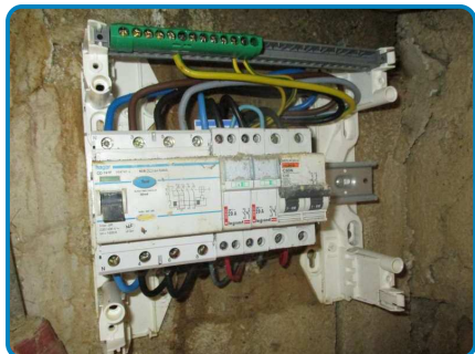
TRP n°2 sur Install. n°1 (dans Dépendance Rez de chaussée Débarras)
