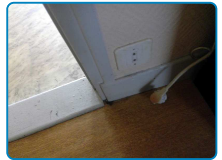
Anomalie B.3.3.6 a1 sur Install. n°2
