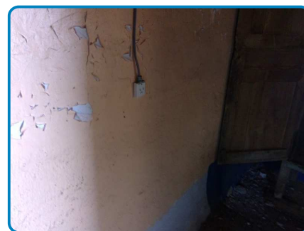
Anomalie B.3.3.6 a1 sur Install. n°1
