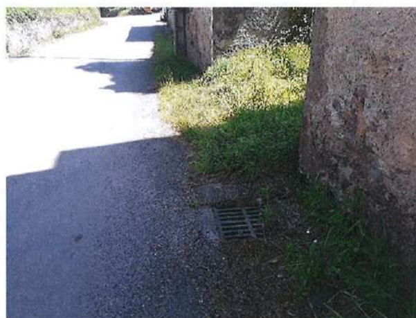
Collecteur pluvial bordant la RD n°279
