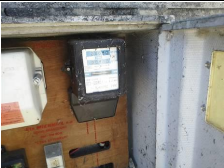
Photo du Compteur électrique
