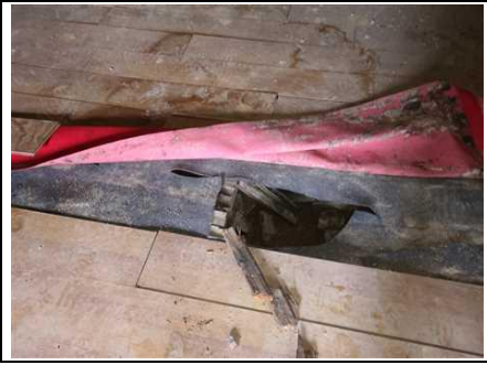
Photo n° effondrement partiel du placner bois de la chambre 1 Localisation : Rez de chaussée - Chambre 1
