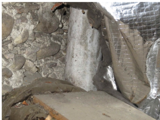
Conduit en amiante ciment comble
