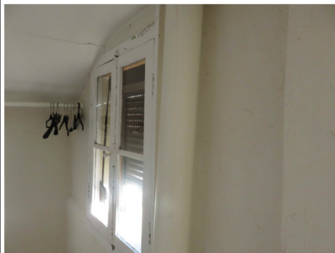
Conduit en amiante ciment pièce 1
