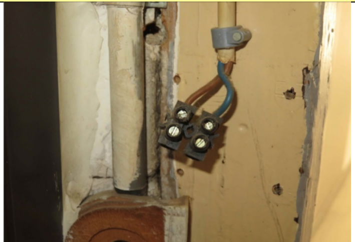
Connexion non protégé entrée
