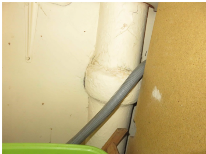
Conduit en amiante ciment local cellier chaudière
