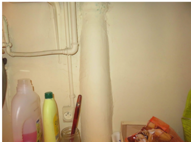
Conduit en amiante ciment local cellier chaudière
