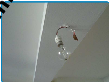
Anomalie B.8.3 b sur Install. n°1
