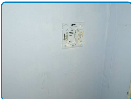
Anomalie B.7.3 a sur Install. n°2
