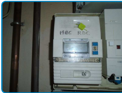
COMPTEUR sur Install. n°2 (dans Rez de chaussée Entrée)
