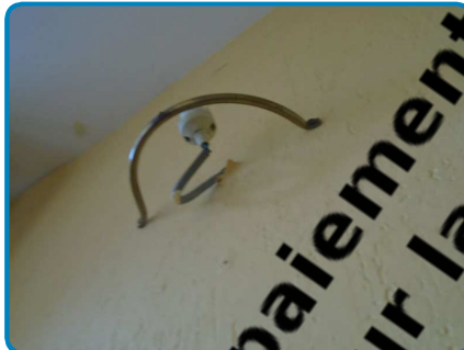
Anomalie B.3.3.6 a3 sur Install. n°1
