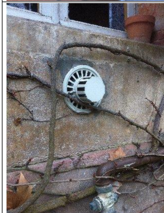
Photo n° Information L'orifice d'évacuation des produits de combustion de l'appareil étanche débouche à l'extérieur d'un bâtiment.
