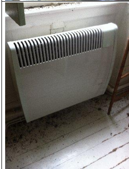
Photo n° DSCN007 Localisation : Étage 1 - Salle de bains 2 Chaudière AUER (Type : Etanche) Localisation sur croquis : Point 007
