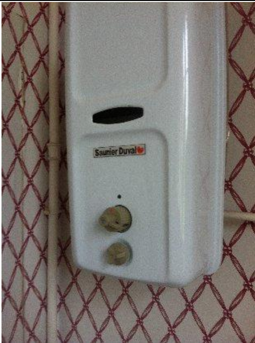
Photo n° DSCN001 Localisation : Étage 1 - Lavabo 2 Chauffe eau SAUNIER DUVAL (Type : Non raccordé) Localisation sur croquis : Point 001
