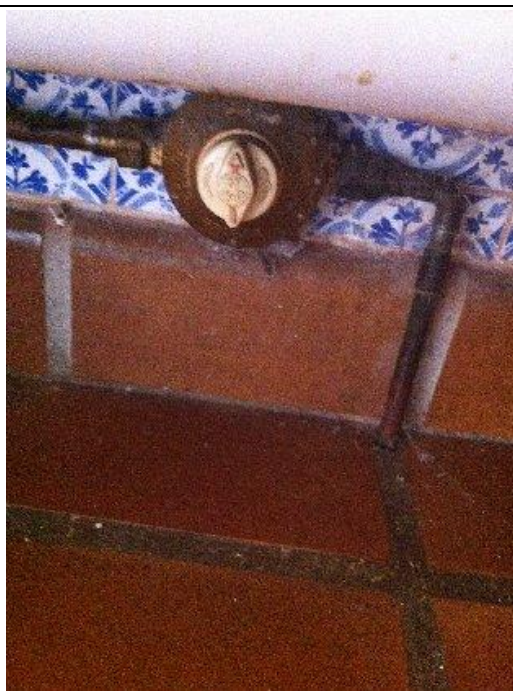
Photo n° Information Au moins un robinet de commande d'appareil est présent.
