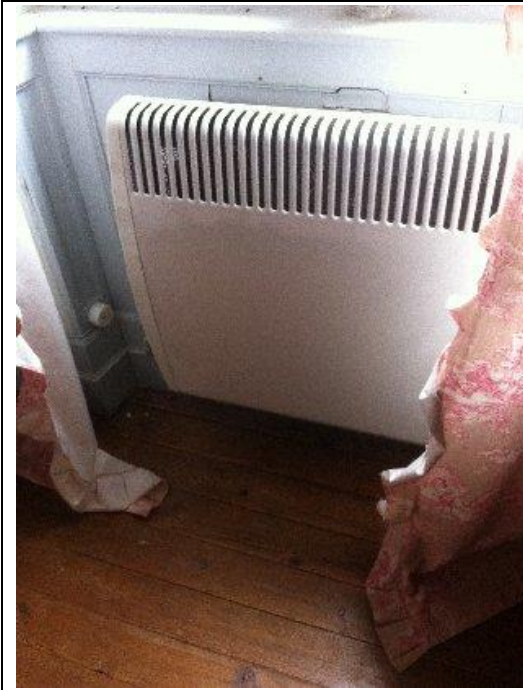
Photo n° DSCN009 Localisation : Étage 1 - Chambre 7 Chaudière AUER (Type : Etanche) Localisation sur croquis : Point 009
