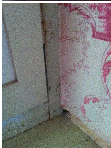
Photo n° repérage Localisation : 0110 UD : Huisserie Fenêtre intérieure (F1) (partie basse )
