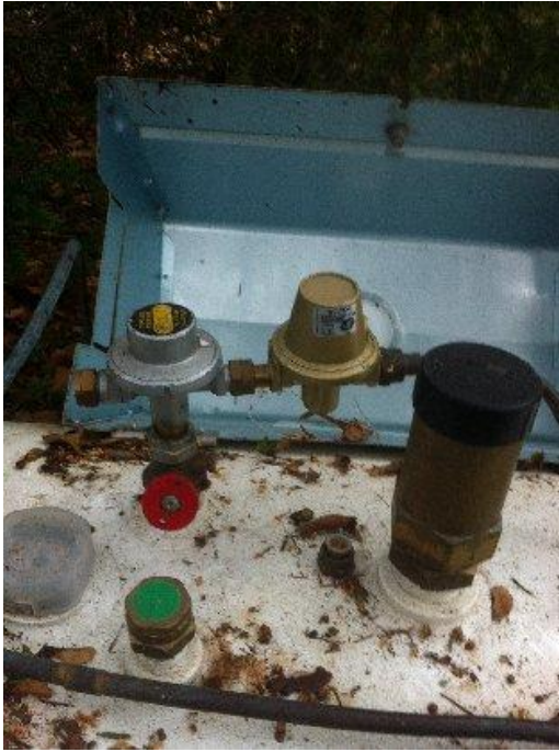
Photo n° Information il y a un limiteur de pression ou de second détenteur sur une installation de GPL en récipient.
