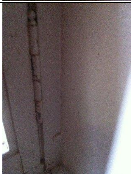
Photo n° repérage Localisation : 0986 UD : Huisserie Fenêtre intérieure (F1) (partie basse )
