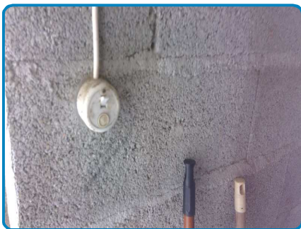
Anomalie B.7.3 e sur Install. n°1
