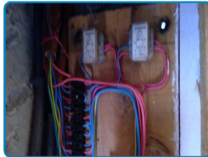
Anomalie B.8.3 e sur Install. n°1
