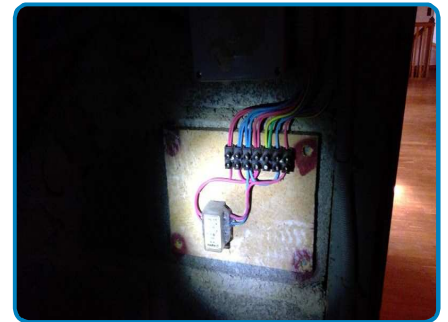
Anomalie B.7.3 d sur Install. n°1
