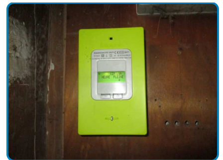
COMPTEUR sur Install. n°1 (dans Rez de chaussée Chaufferie)
