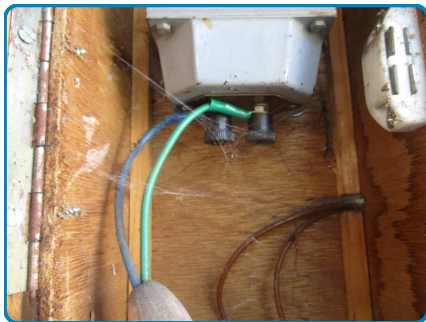
Anomalie B.7.3 c2 sur Install. n°1
