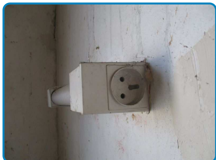
Anomalie B.3.3.6 a2 sur Install. n°1
