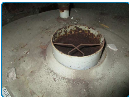
Anomalie 28a (DGI) sur Install.n°1 Appareil n°2
