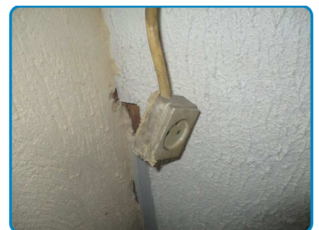
Anomalie B.3.3.6 a1 sur Install. n°1
