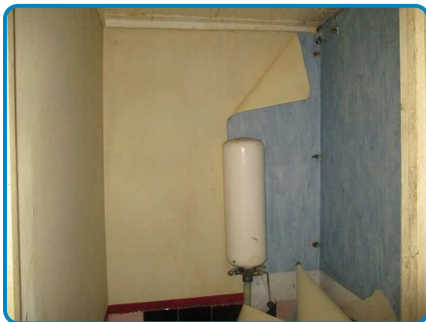
D.O. n° 4 sur Murs A B C D Plaques fibres ciment Peinture / D
