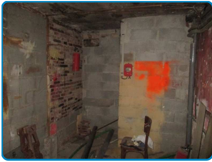
Rez de chaussée Chaufferie
