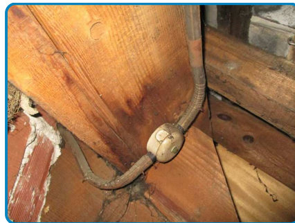
Anomalie B.8.3 a sur Install. n°1
