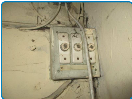
Anomalie B.7.3 e sur Install. n°1 App. n°1 (TRS n°1)
