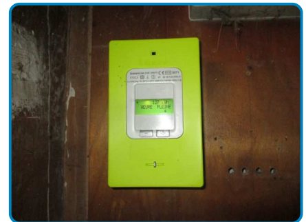
COMPTEUR sur Install. n°1 (dans Rez de chaussée Chaufferie)
