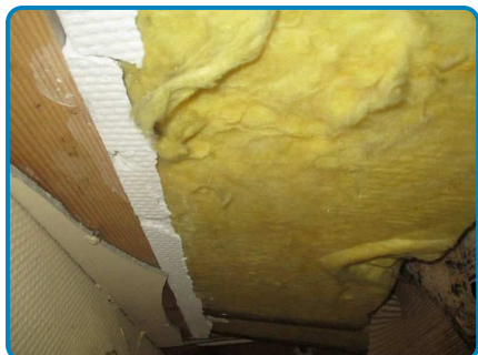
D.O. n° 10 sur Plafond montée 2ème étage Fragments Plaques fibres ciment Peinture
