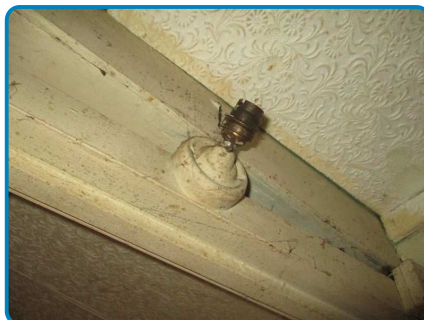
Anomalie B.3.3.6 a3 sur Install. n°1
