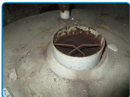
Anomalie 28a (DGI) sur Install.n°1 Appareil n°2
