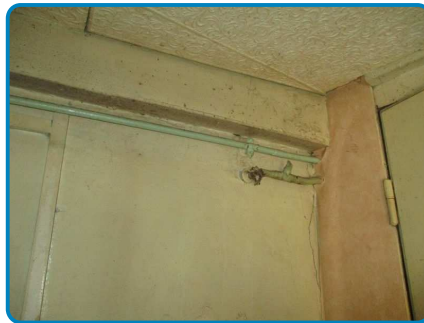
D.O. n° 2 sur Murs B C D Plaques fibres ciment Peinture
