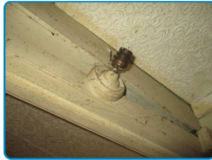
Anomalie B.3.3.6 a3 sur Install. n°1
