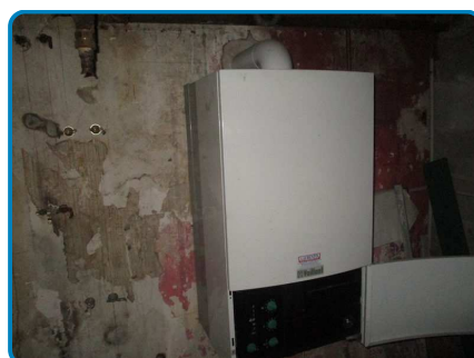
Appareil n°1 (Chaudière chauffage) sur installation n°1 (dans Rez de chaussée Chaufferie)
