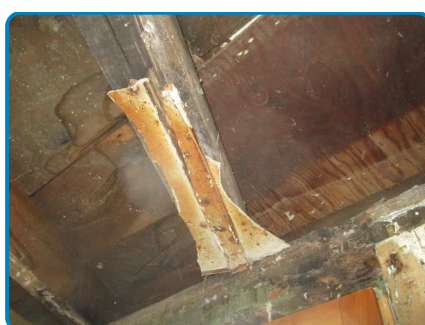
D.O. n° 8 sur Plafond Fragments de plaques
