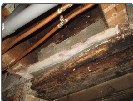
D.O. n° 8 sur Plafond Fragments de plaques
