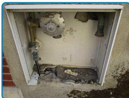
Installation n°1 (Gaz naturel) (dans Rez de chaussée Extérieur)
