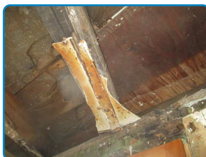
D.O. n° 8 sur Plafond Fragments de plaques
