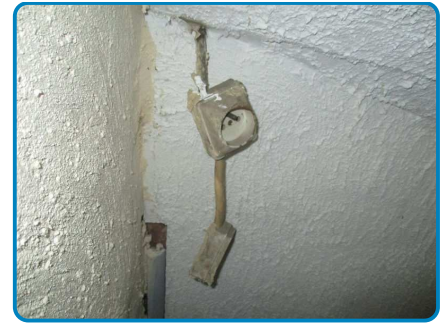
Anomalie B.7.3 a sur Install. n°1
