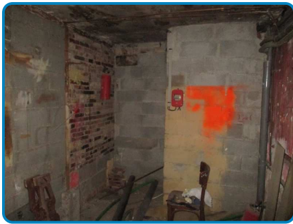
Rez de chaussée Chaufferie
