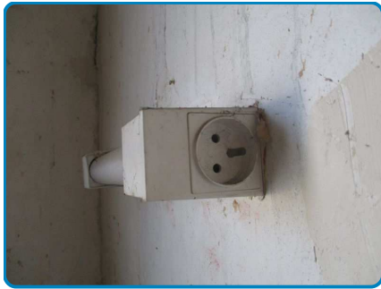
Anomalie B.3.3.6 a2 sur Install. n°1
