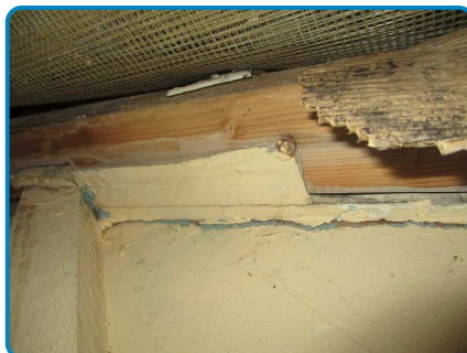
D.O. n° 10 sur Plafond montée 2ème étage Fragments Plaques fibres ciment Peinture
