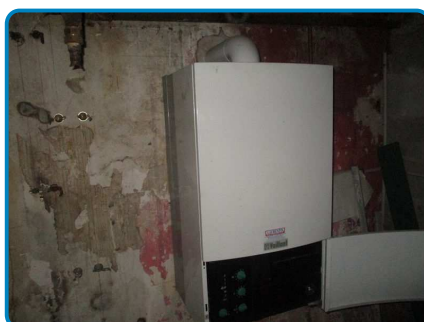
Appareil n°1 (Chaudière chauffage) sur installation n°1 (dans Rez de chaussée Chaufferie)
