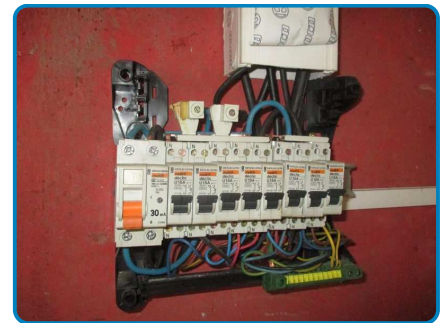
TRP n°2 sur Install. n°1 (dans Rez de chaussée Pièce n°3)
