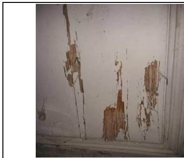
Photo n° PhTer001 Localisation : Rez de chaussée - Gde salle 8 Ouvrage : Parements - Bois et Peinture Parasite : Présence d'indices d'infestation de termites Indices : altérations dans le bois
