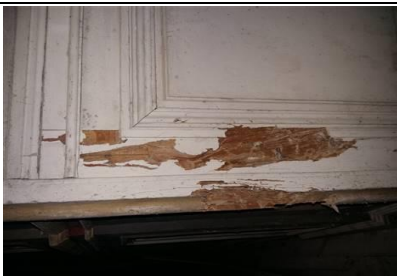
Photo n° PhTer001 Localisation : Rez de chaussée - Gde salle 8 Ouvrage : Parements - Bois et Peinture Parasite : Présence d'indices d'infestation de termites Indices : altérations dans le bois
