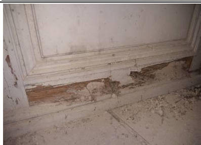
Photo n° PhTer001 Localisation : Rez de chaussée - Gde salle 8 Ouvrage : Parements - Bois et Peinture Parasite : Présence d'indices d'infestation de termites Indices : altérations dans le bois
