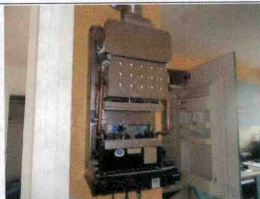
Photo n° Ph001 Localisation : Cuisine Chaudière CHAFFOTEAUX & MAURY (Type : Raccordé)
