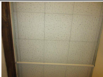
Photo n° D13 (en cours d'analyse) Localisation : Étage 2 et 3 - Couloir, Chambres R+3 Ouvrage : Plafonds et faux plafonds - Faux-plafonds Partie d'ouvrage : Panneaux et plaques Description : plaques de faux plafond motif piqué Localisation sur croquis : D13
