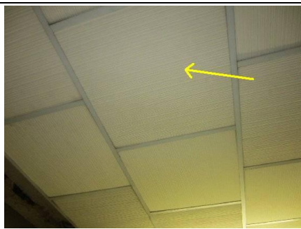
Photo n° D6 Localisation : Étage 1 - Plonge Ouvrage : Plafonds et faux plafonds - Faux-plafonds Partie d'ouvrage : Panneaux et plaques Description : Panneaux en fibrociment au plafond Localisation sur croquis : D6
