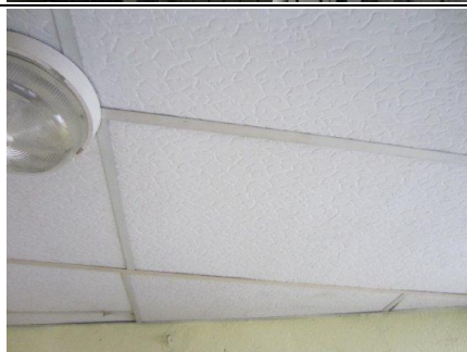
Photo n° D8 (en cours d'analyse) Localisation : Étage 2 - Terrasse Ouvrage : Plafonds et faux plafonds - Faux-plafonds Partie d'ouvrage : Panneaux et plaques Description : Panneaux en fibrociment sur la terrasse Localisation sur croquis : D8
