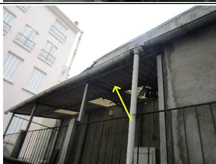
Photo n° D9 Localisation : Étage 2 - Terrasse Ouvrage : Toiture, terrasse et étanchéité - Plaques ondulées et planes Partie d'ouvrage : Plaques en fibres-ciment Description : Plaques en fibres-ciment en couverture de la terrasse Localisation sur croquis : D9
