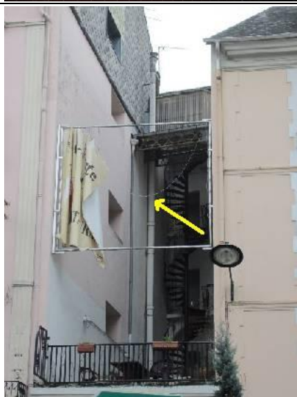
Photo n° D12 Localisation : Bâtiment Ouvrage : Conduits, canalisations et accessoires intérieurs et extérieurs - Conduits de vapeur, fumée, échappement Partie d'ouvrage : Conduit Description : Conduit en fibrociment façade OUEST Localisation sur croquis : D12
