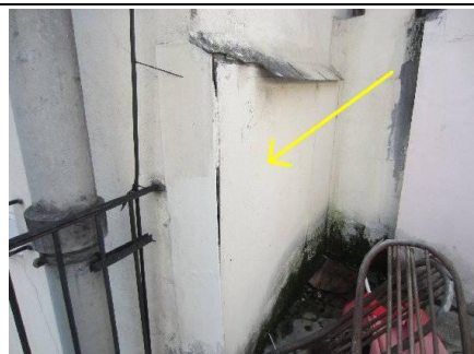
Photo n° D14 Localisation : Étage 5 - Chambre 43 Ouvrage : Parois verticales extérieures - Bardages Partie d'ouvrage : Plaques Description : Plaques de fibrociment sur la terrasse Localisation sur croquis : D14
