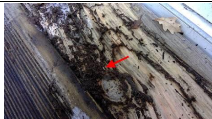
Photo n° PhTer001 Localisation : Jardin Ouvrage : Terrasse bois Chambre 2 Parasite : Présence d'indices d'infestation de termites, Termites souterrains Indices : altérations dans le bois, termites souterrains vivants
