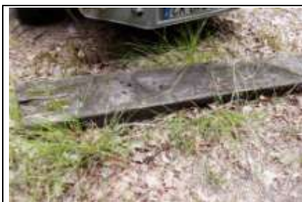
Photo n° PhTer001 Localisation : Parties extérieures : bois au sol, souches Parasite : Insectes à larves xylophages, Champignon de pourriture cubique Indices : bois piqué, décoloration du bois
