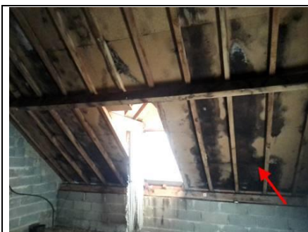
Photo n° PhTer001 Localisation : 1er étage - Combles d'habitation 1; 1er étage - Combles d'habitation 2; 1er étage - Combles d'habitation 3 Parasite : Moisissures Indices : dégradation du bois (dégradation(s) importante(s))
