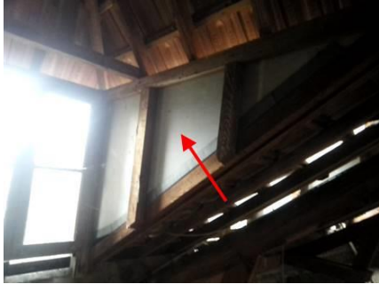
Photo n° PhA002 Localisation : Rez de chaussée - Sanitaires; Rez de chaussée - Dégagement; 1er étage - Coursive; 1er étage - Salle de restaurant; 1er étage - Sanitaires; 1er étage - Pièce 4 Ouvrage : 2 - Parois verticales extérieures et Façades - Façades légères, murs rideaux, bardages, panneaux sandwich Partie d'ouvrage : Plaques Description : Plaques
