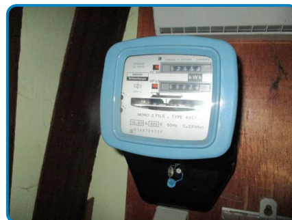
COMPTEUR sur Install. n°1 (dans Rez de chaussée Espace de vente)
