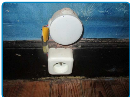
Anomalie B.3.3.6 a2 sur Install. n°1
