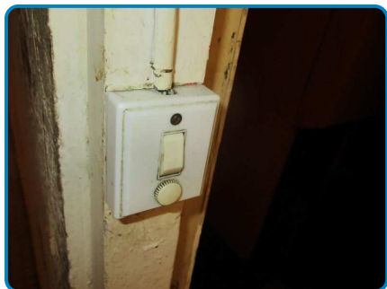
Anomalie B.7.3 e sur Install. n°1
