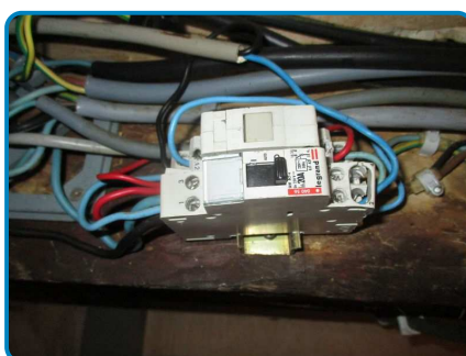
Anomalie B.7.3 a sur Install. n°1 App. n°2 (TRS n°2)
