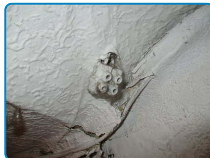
Anomalie B.7.3 d sur Install. n°1
