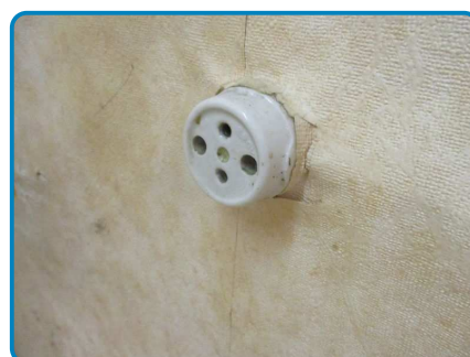
Anomalie B.3.3.6 a1 sur Install. n°1
