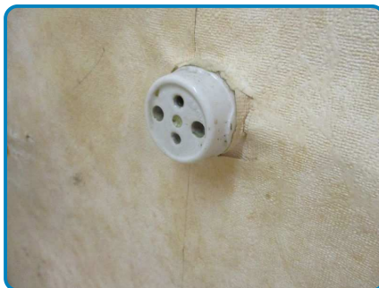
Anomalie B.8.3 a sur Install. n°1
