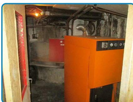
Rez de chaussée Chaufferie
