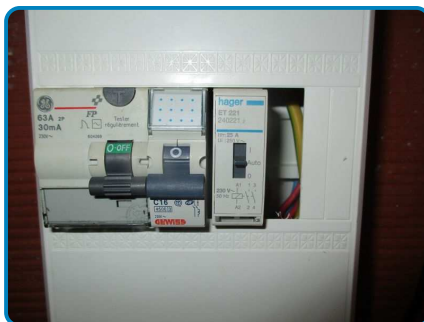
Anomalie B.7.3 a sur Install. n°1 App. n°1 (TRS n°1)
