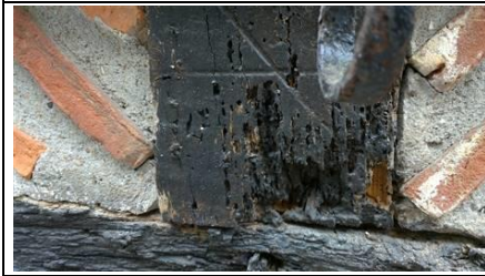
Photo n° PhTer005 Localisation : Extérieur facade colombage Ouvrage : colombage Parasite : Présence d'indices d'infestation de termites Indices : altérations dans le bois, dégradation du bois (dégradation(s) importante(s))
