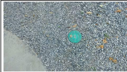
Photo n° PhTer004 Localisation : Rez de jardin - Extérieur Ouvrage : Sol Parasite : Présence d'indices d'infestation de termites Indices : galeries-tunnels (dégradation(s) faible(s))
