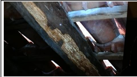
Photo n° PhTer002 Localisation : 1er étage - Combles Ouvrage : Charpente - Charpente Parasite : Présence d'indices d'infestation de termites Indices : altérations dans le bois, bois d'apparence feuilleté, dégradation du bois (dégradation(s) importante(s))
