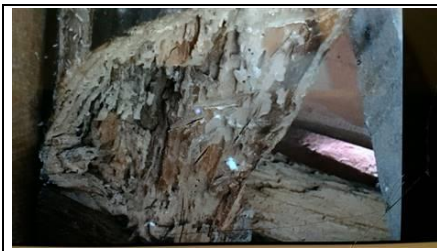
Photo n° PhTer001 Localisation : 1er étage - Combles Ouvrage : Charpente - Charpente Parasite : Présence d'indices d'infestation de termites Indices : altérations dans le bois, bois d'apparence feuilleté, dégradation du bois (dégradation(s) importante(s))
