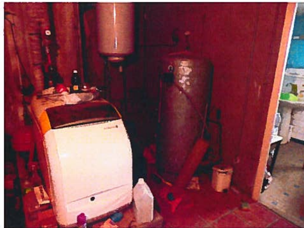
Chaufferie-Chaudière-cumulus et réservoir d'eau du puits
