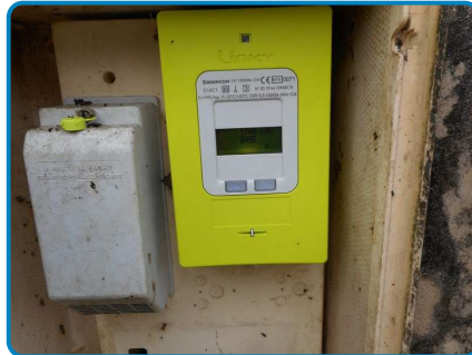
COMPTEUR sur Install. n°3 (dans Parties communes Rez de chaussée Extérieur)
