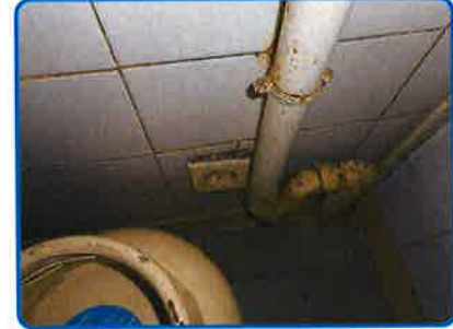
Anomalie B.8.3 b sur Install. n°1
