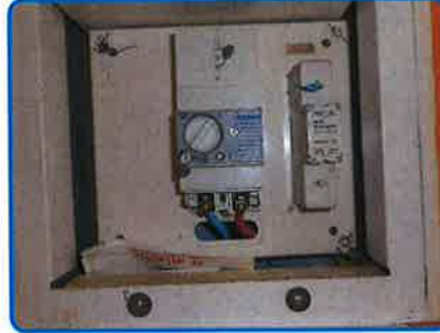
Anomalie B.3.3.6 a3 sur Install. n°1
