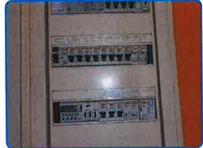
Anomalie B.7.3 a sur Install. n°1
