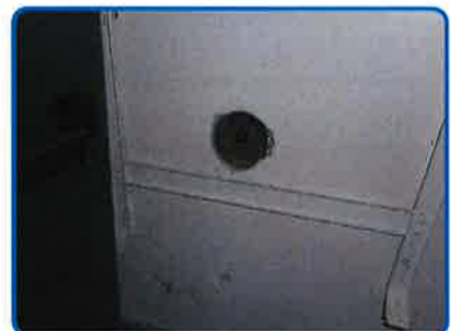
Anomalie B.7.3 d sur Install. n°3
