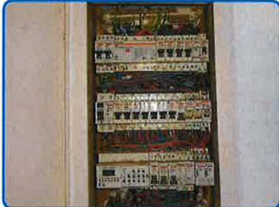
Anomalie B.4.3 f3 sur Install. n°3 App. n°1 (TRP n°1)
