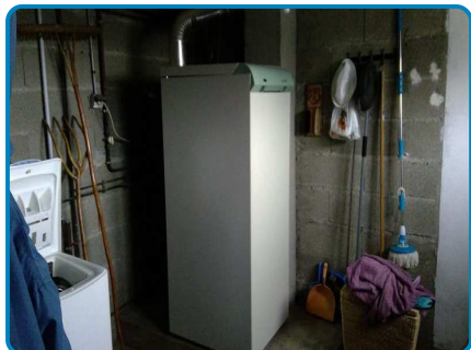
Maison principale Rez de chaussée Chaufferie
