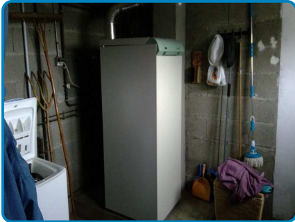
Maison principale Rez de chaussée Chaufferie
