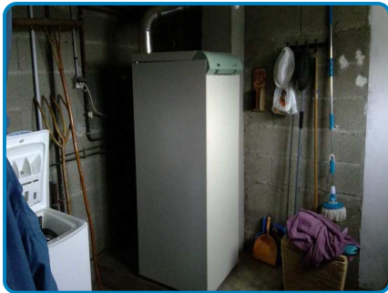
Maison principale Rez de chaussée Chaufferie
