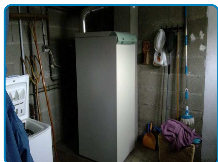
Maison principale Rez de chaussée Chaufferie
