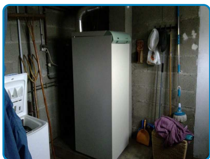
Maison principale Rez de chaussée Chaufferie
