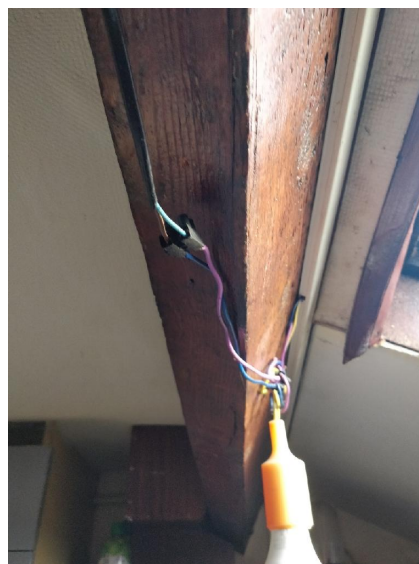
B.8.3 e) : Au moins un conducteur isolé n'est pas placé sur toute sa longueur dans un conduit, une goulotte, une plinthe ou une huisserie, en matière isolante ou métallique, jusqu'à sa pénétration dans le matériel électrique qu'il alimente.
