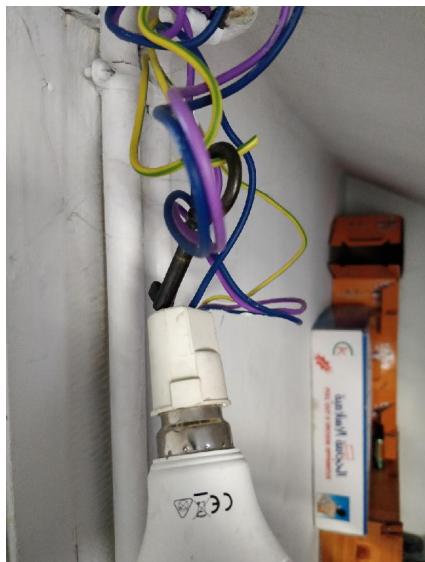
B.8.3 b) : L'installation comporte au moins un matériel électrique inadapté à l'usage.
