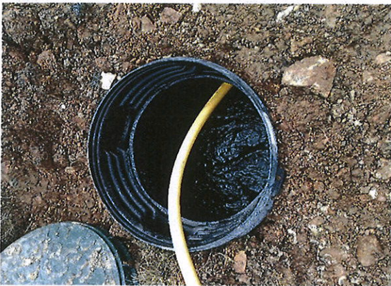
Fosse toutes eaux
