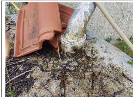
Photo n° PhA001 Localisation : Parties extérieures Ouvrage : 6 - Conduits et accessoires intérieurs - Conduits de fluides (air, eau, vapeur, fumée, échappement, autres fluides) Partie d'ouvrage : Conduit en fibres-ciment Description : Conduit en fibres-ciment
