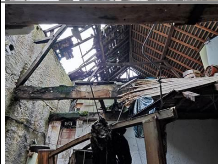
Photo n° T Ouvrage : Charpente couverture en partie effondrée + débris divers au sol
