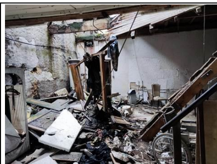
Photo n° T Ouvrage : Charpente couverture en partie effondrée + débris divers au sol
