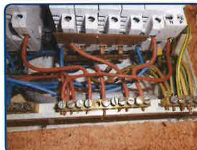
Anomalie B.7.3 d sur Install. n°1 App. n°5 (TRP n°5)
