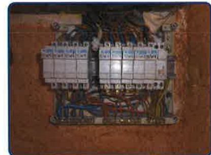
Anomalie B.4.3 f1 sur Install. n°1 App. n°5 (TRP n°5)
