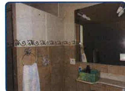
Anomalie B.6.3.1 a sur Install. n°1 App. n°2
