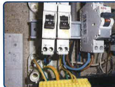
Install. n°1 App. n°4 (TRP n°4): Les calibres de certains disjoncteurs sont illisibles
