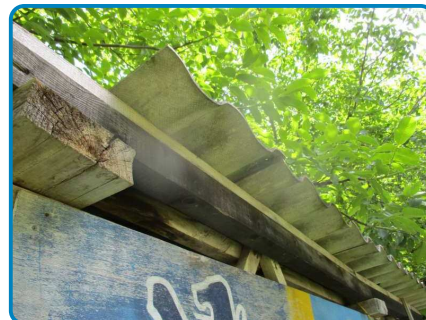
D.O. n° 3 sur Toiture appenti Plaques fibres ciment
