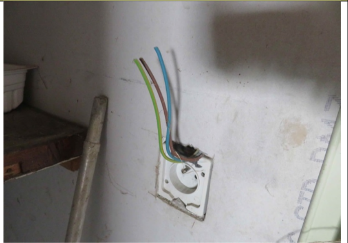
Conducteurs non protégé (en attente de raccordement )
