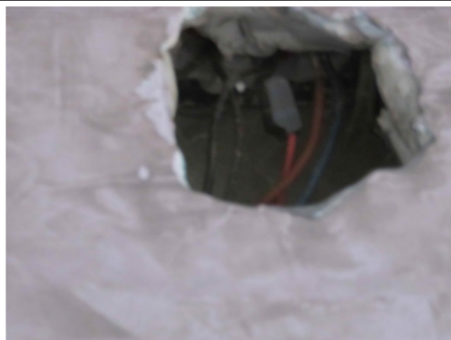
Absence de cache entrée dégagement
