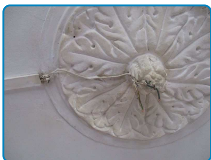
Anomalie B.7.3 c2 sur Install. n°1
