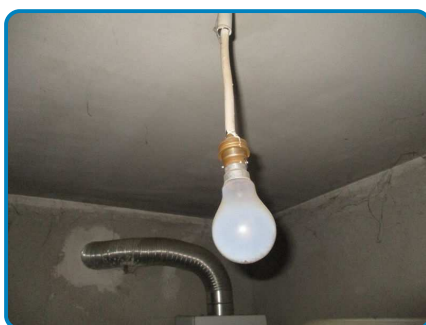
Anomalie B.8.3 a sur Install. n°1
