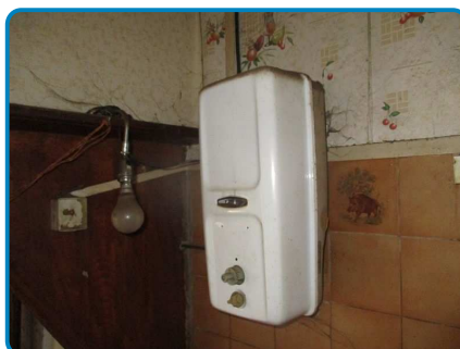
Appareil n°2 (Chauffe-eau) sur installation n°1 (dans Maison principale Rez de chaussée Cuisine)
