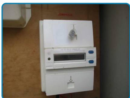
COMPTEUR sur Install. n°1 (dans Maison principale Rez de chaussée Extérieur)
