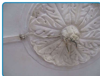
Anomalie B.8.3 e sur Install. n°1
