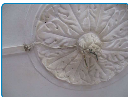
Anomalie B.3.3.6 a3 sur Install. n°1
