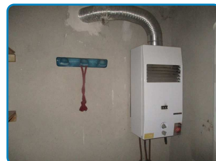
Appareil n°3 (Chauffe-eau) sur installation n°1 (dans Maison principale Rez de chaussée Cellier)
