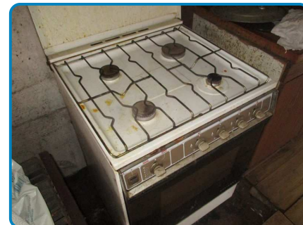
Appareil n°1 (Cuisinière) sur installation n°1 (dans Maison principale Rez de chaussée Cuisine)
