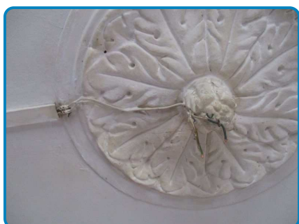
Anomalie B.7.3 d sur Install. n°1
