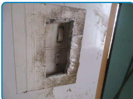
Anomalie B.3.3.6 a1 sur Install. n°1
