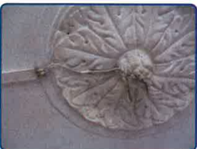
Anomalie B.7.3 d sur Install. n°1
