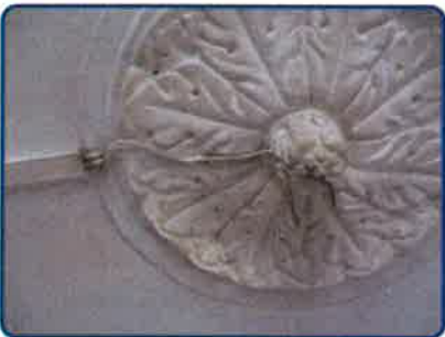
Anomalie B.7.3 c2 sur Install. n°1
