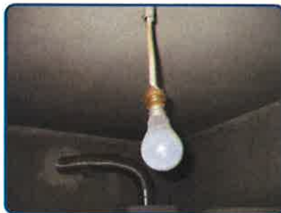
Anomalie B.8.3 a sur Install. n°1
