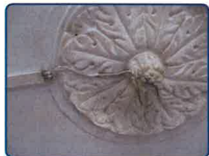
Anomalie B.8.3 e sur Install. n°1
