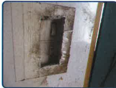
Anomalie B.3.3.6 a1 sur Install. n°1
