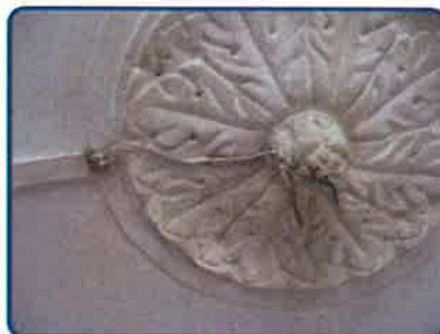
Anomalie B.3.3.6 a3 sur Install. n°1
