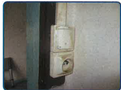
Anomalie B.3.3.6 a2 sur Install. n°1
