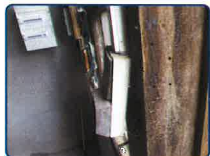
Anomalie B.7.3 a sur Install. n°1
