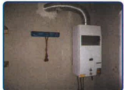
Appareil n°3 (Chauffe-eau) sur installation n°1 (dans Maison principale Rez de chaussée Cellier)
