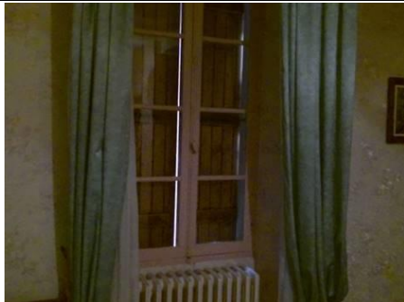
Photo n° PhPb010 Localisation : 1er étage - Chambre 3 UD : Fenêtre intérieure (partie basse)
