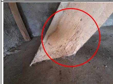
Photo n° PhTer005 Localisation : Dépendance - Pièce 1 Ouvrage : Escalier - Bois Parasite : Présence d'indices d'infestation d'autres agents de dégradation biologique du bois Indices : altérations dans le bois, bois piqué (dégradation(s) faible(s))
