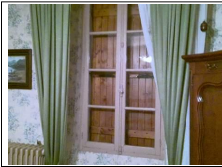
Photo n° PhPb007 Localisation : 1er étage - Chambre 2 UD : Fenêtre 1 intérieure (partie basse)
