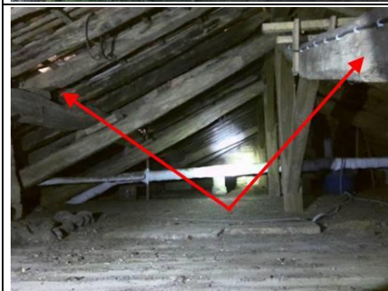
Photo n° PhTer010 Localisation : Comble - Comble non habitables Ouvrage : Charpente en bois Parasite : Présence d'indices d'infestation d'autres agents de dégradation biologique du bois Indices : altérations dans le bois, bois piqué (dégradation(s) faible(s))
