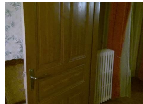
Photo n° PhPb006 Localisation : 1er étage - Chambre 2 UD : Porte 1 (partie basse)
