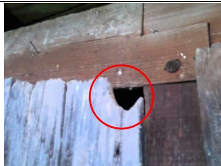
Photo n° PhTer001 Localisation : Poulailler - Pièce 1 Ouvrage : Porte - A - Bois Parasite : Présence d'indices d'infestation d'autres agents de dégradation biologique du bois Indices : altérations dans le bois, bois piqué (dégradation(s) faible(s))
