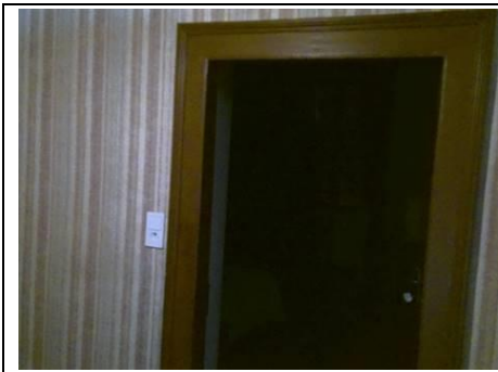
Photo n° Ph Localisation : Rez de jardin - Chambre 1 UD : Huisserie Porte (partie basse)
