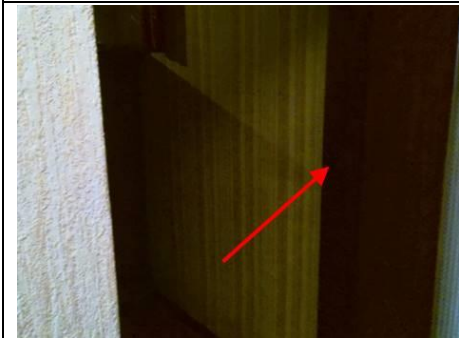
Photo n° PhPb004 Localisation : Rez de jardin - Couloir UD : Huisserie Porte 2 (partie basse)
