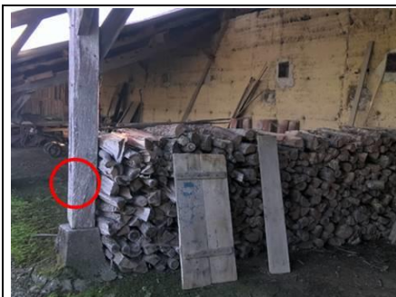
Photo n° PhTer008 Localisation : Porcherie - Pièce 3 Ouvrage : Poteaux en bois Parasite : Présence d'indices d'infestation d'autres agents de dégradation biologique du bois Indices : altérations dans le bois, bois piqué (dégradation(s) faible(s))
