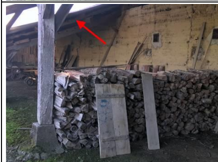
Photo n° PhTer009 Localisation : Porcherie - Pièce 3 Ouvrage : Charpente en bois Parasite : Présence d'indices d'infestation d'autres agents de dégradation biologique du bois Indices : altérations dans le bois, bois piqué (dégradation(s) faible(s))
