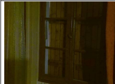
Photo n° PhPb005 Localisation : 1er étage - Palier UD : Fenêtre intérieure (partie basse)
