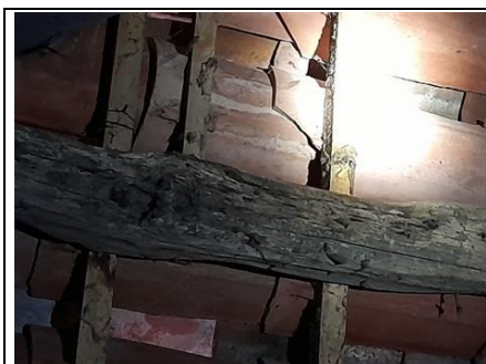
Photo n° PhTer003 Localisation sur croquis : Porcherie - Pièce 3 Ouvrage : Charpente en bois
