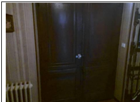
Photo n° PhPb001 Localisation : Rez de jardin - Entrée UD : Porte (partie basse)
