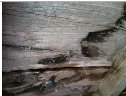
Photo n° PhTer002 Localisation : Poulailler - Pièce 1 Ouvrage : Plafond en bois Parasite : Présence d'indices d'infestation d'autres agents de dégradation biologique du bois Indices : décoloration du bois (dégradation(s) faible(s))
