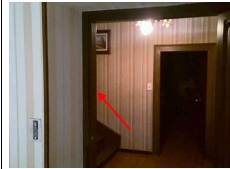
Photo n° PhPb003 Localisation : Rez de jardin - Séjour UD : Huisserie Porte (partie basse)
