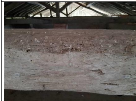
Photo n° PhTer006 Localisation : Porcherie R+1 - Pièce 5 Ouvrage : Charpente en bois Parasite : Présence d'indices d'infestation d'autres agents de dégradation biologique du bois Indices : altérations dans le bois, bois piqué (dégradation(s) faible(s))
