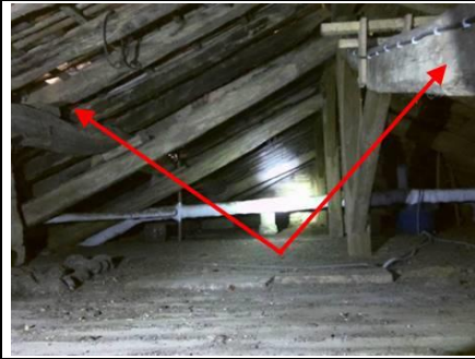
Photo n° PhTer010 Localisation : Comble - Comble non habitables Ouvrage : Charpente en bois Parasite : Présence d'indices d'infestation d'autres agents de dégradation biologique du bois Indices : altérations dans le bois, bois piqué (dégradation(s) faible(s))
