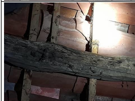
Photo n° PhTer004 Localisation : Dépendance R+1 - Pièce 4 Ouvrage : Charpente bois Parasite : Présence d'indices d'infestation d'autres agents de dégradation biologique du bois Indices : altérations dans le bois, bois piqué (dégradation(s) faible(s))
