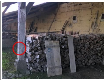
Photo n° PhTer008 Localisation : Porcherie - Pièce 3 Ouvrage : Poteaux en bois Parasite : Présence d'indices d'infestation d'autres agents de dégradation biologique du bois Indices : altérations dans le bois, bois piqué (dégradation(s) faible(s))
