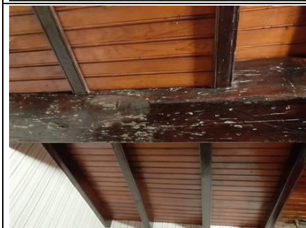
Photo n° PhTer007 Localisation : Rez de jardin - Chambre 1 Ouvrage : Poutre en bois Parasite : Présence d'indices d'infestation d'autres agents de dégradation biologique du bois Indices : altérations dans le bois, bois piqué (dégradation(s) faible(s))
