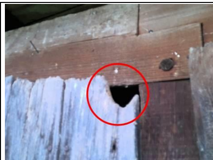
Photo n° PhTer001 Localisation : Poulailler - Pièce 1 Ouvrage : Porte - A - Bois Parasite : Présence d'indices d'infestation d'autres agents de dégradation biologique du bois Indices : altérations dans le bois, bois piqué (dégradation(s) faible(s))
