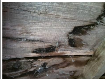
Photo n° PhTer002 Localisation : Poulailler - Pièce 1 Ouvrage : Plafond en bois Parasite : Présence d'indices d'infestation d'autres agents de dégradation biologique du bois Indices : décoloration du bois (dégradation(s) faible(s))
