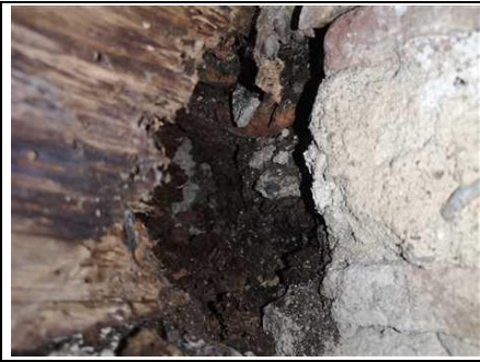
Photo n° PhTer006 Localisation : 1er étage - Grenier 2 Ouvrage : Plafond - poutres bois et isolant Parasite : Présence d'indices d'infestation de termites, Termites souterrains Indices : altérations dans le bois
