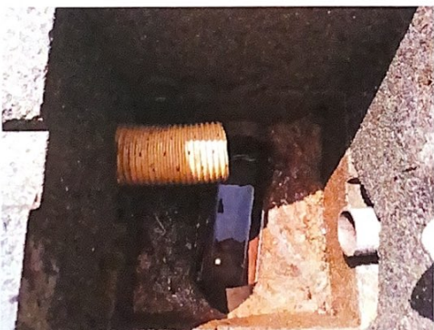
1 er regard intermédiaire (de collecte) après la fosse du gîte
