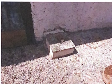
regard situé en amont de la fosse toutes eaux du gîte
