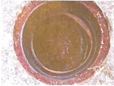
Fosse toutes eaux (colmatée) de l'habitation
