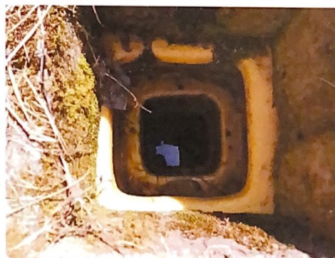
2 ème regard intermédiaire après la fosse du gîte
