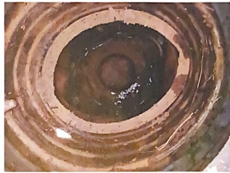
Regard de répartition déformé
